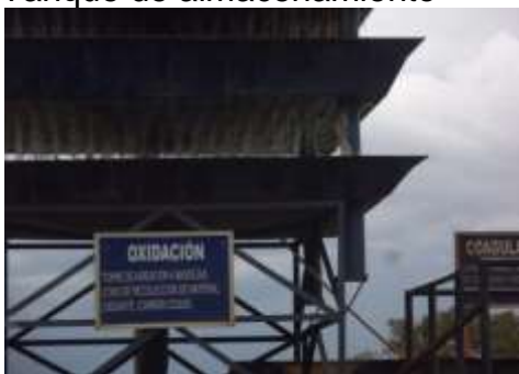
Tanque de oxidación
