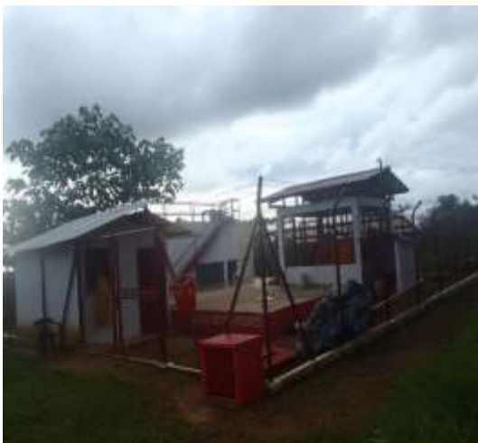
Planta de tratamiento de agua potable.
