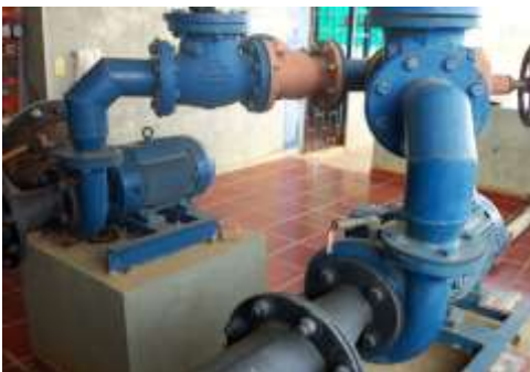
Estación de Bombeo
